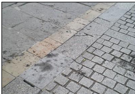
Manchas de aceite, losetas quebradas...
