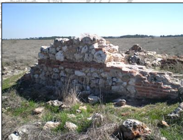
Ladrillo y sillarejo. Pintadas y vandalismo
