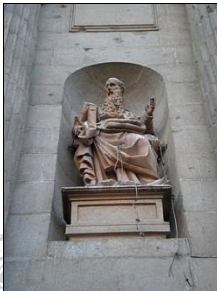
Cables colgando entre las estatuas
