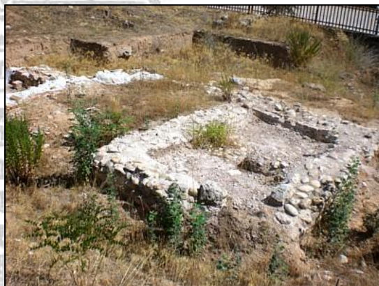
Y el vandalismo destruye las estructuras
