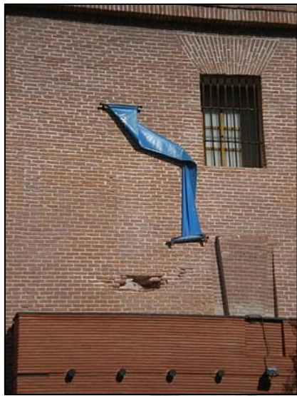
Daños en la fachada
