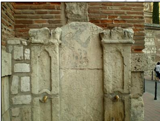
Degradación y grifos inadecuados
