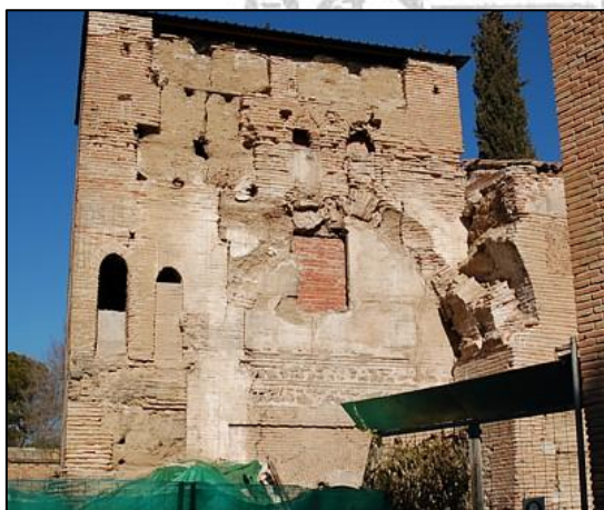
Estado tras el derrumbe
