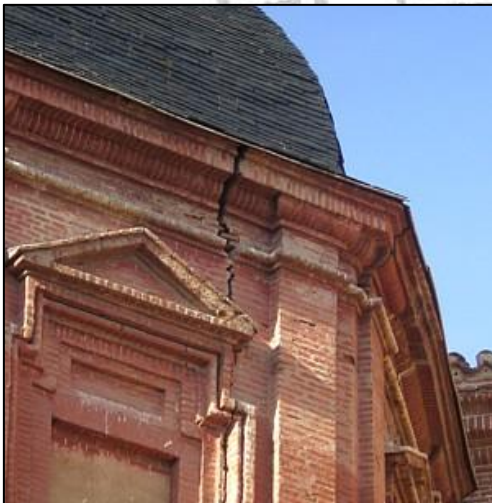
Grietas en el exterior
