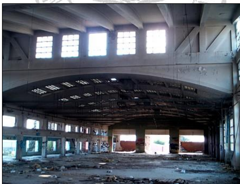
Lamentable estado del interior
