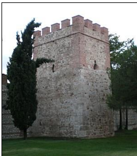
Árboles mal ubicados
