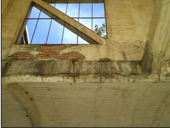
La degradación es visible
