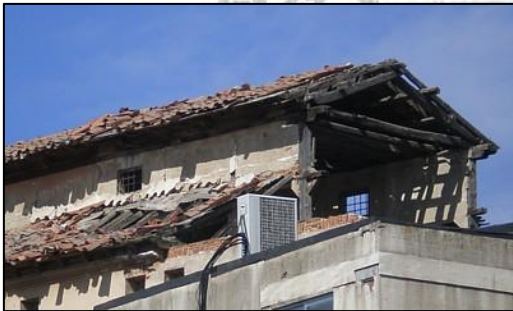
Abandono y ruina inminente
