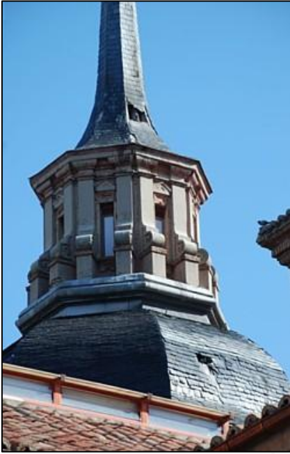
Daños en las cubiertas de pizarra
