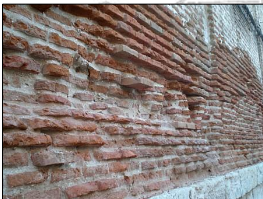
Importante degradación en los muros
