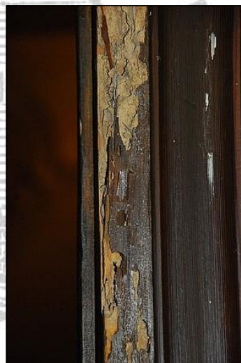
Xilófagos y daños en madera
