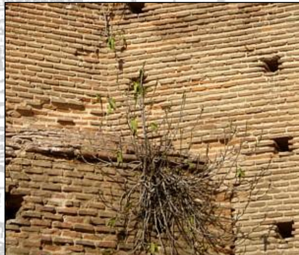
Vegetación y erosión
