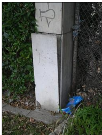
Desprendimiento y grafitos
