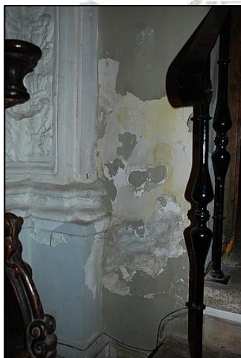
Humedades en paramentos
