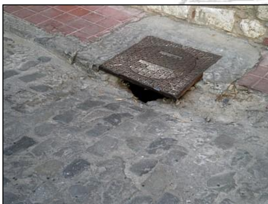
Lamentable estado de conservación
