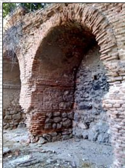
Daños que continúan
