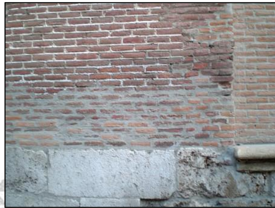
Restauración deficiente en el exterior del MAR
