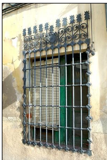
Reja en fachada
