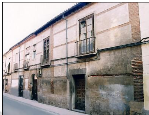
Aspecto antes del 'hundimiento'
