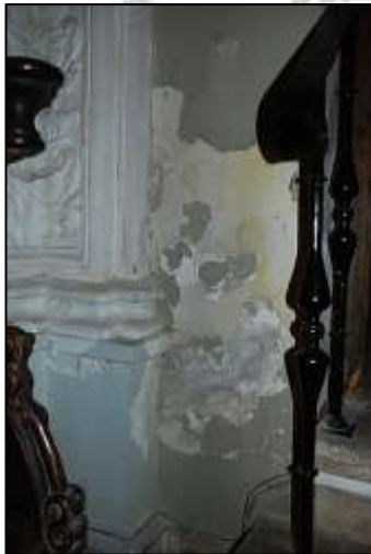
Humedades en paramentos
