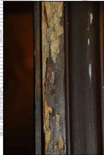
Xilófagos y daños en madera
