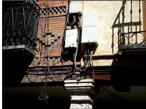
Pupurrí de cajetines y cables en la C/ Mayor
