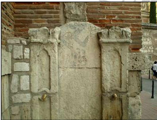
Degradación y grifos inadecuados
