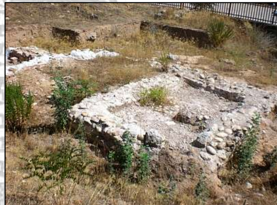
Y el vandalismo destruye las estructuras
