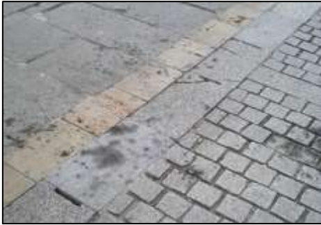
Manchas de aceite, losetas quebradas...
