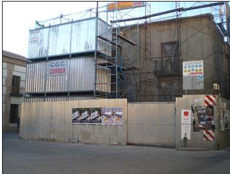
Estado actual: una obra paralizada por muchos años
