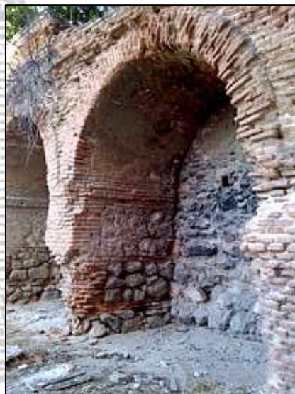
Daños que continúan
