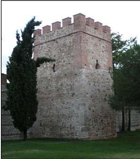
Árboles mal ubicados
