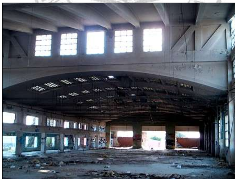
Lamentable estado del interior
