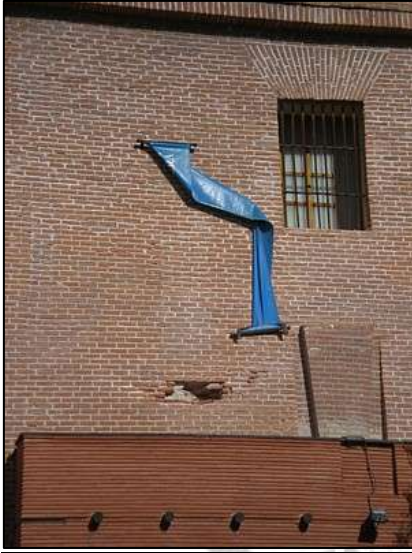
Daños en la fachada
