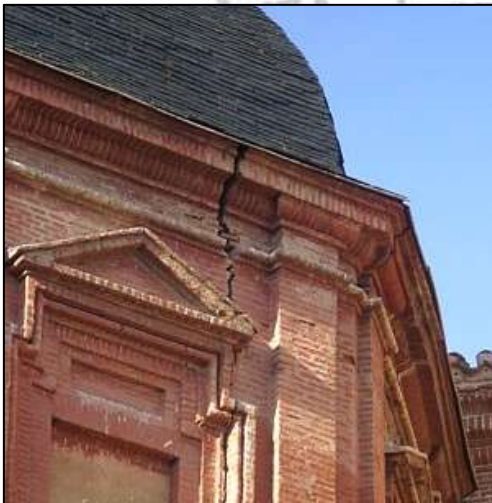
Grietas en el exterior
