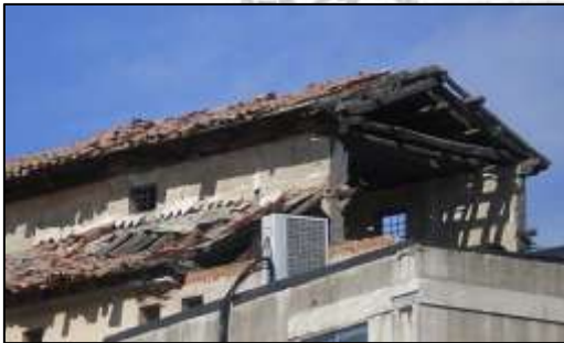
Abandono y ruina inminente
