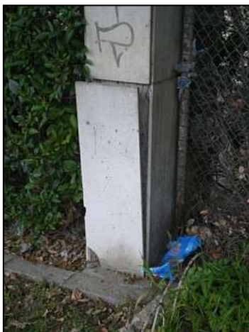
Desprendimiento y grafitos
