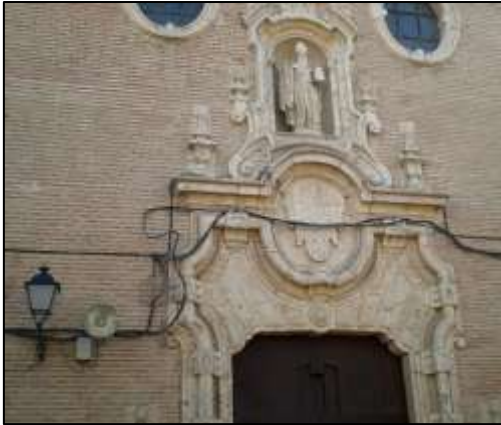
Cables, farolas y focos; no falta de nada
