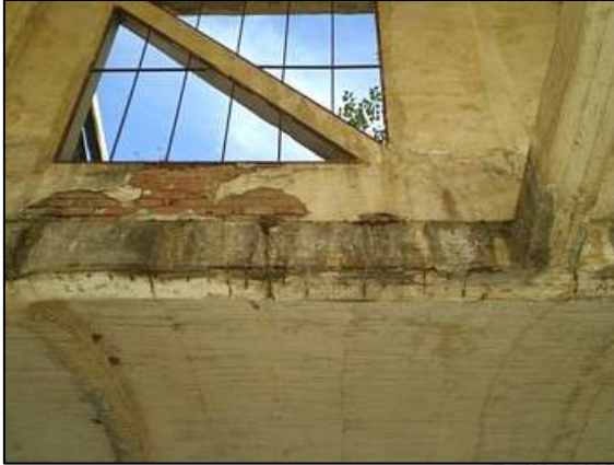
La degradación es visible
