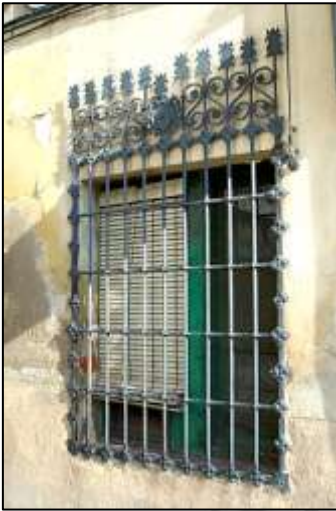
Reja en fachada
