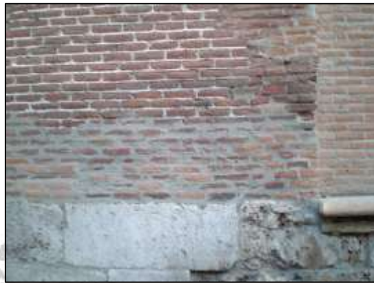
Restauración deficiente en el exterior del MAR
