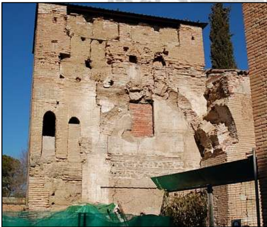
Estado tras el derrumbe
