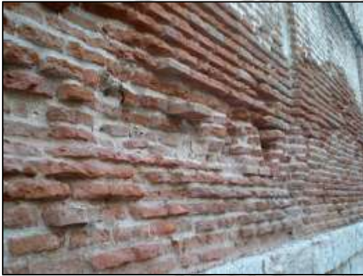
Importante degradación en los muros
