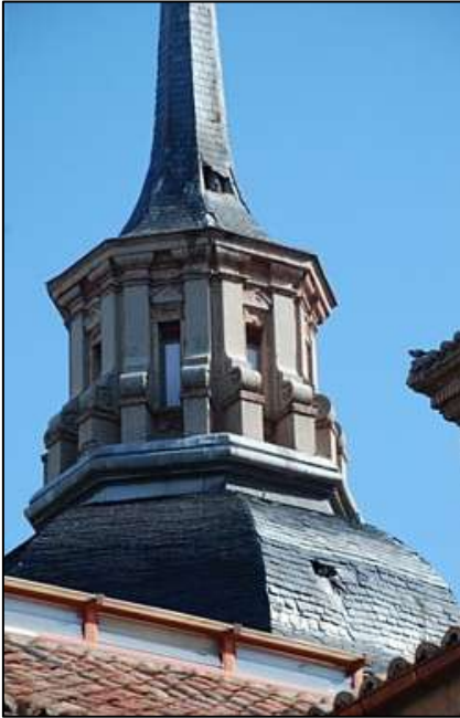
Daños en las cubiertas de pizarra
