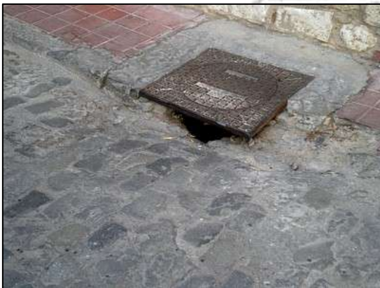
Lamentable estado de conservación
