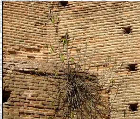
Vegetación y erosión
