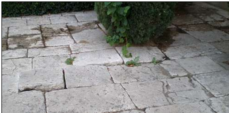
Trinitarios Descalzos, ante fachada: daños por arbolado y fugas de agua
